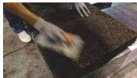
9. Creazione dello scasso per ospitare il collante bituminoso e lo spessore della guaina
